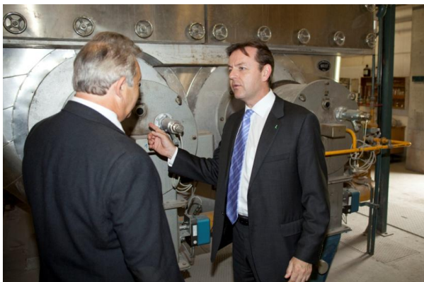
Berlakovich besichtigt den Economizer, durch den aufgrund von Energierückgewinnung knapp 20% des Erdgas-Energieverbrauchs eingespart werden.
